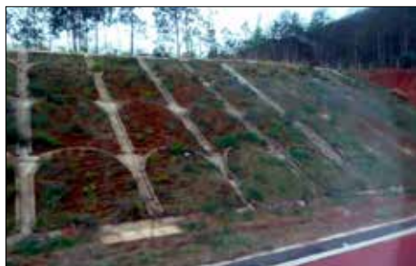
Svahy byly zpevněny betonovým žebrovím a přesto se někdy utrhly
